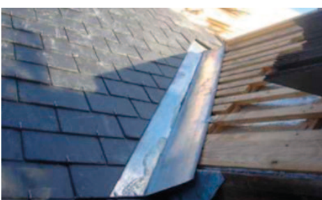
Noue en zinc
