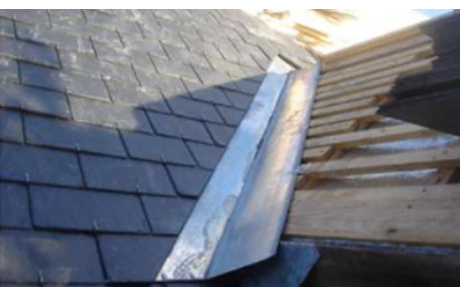
Noue en zinc
